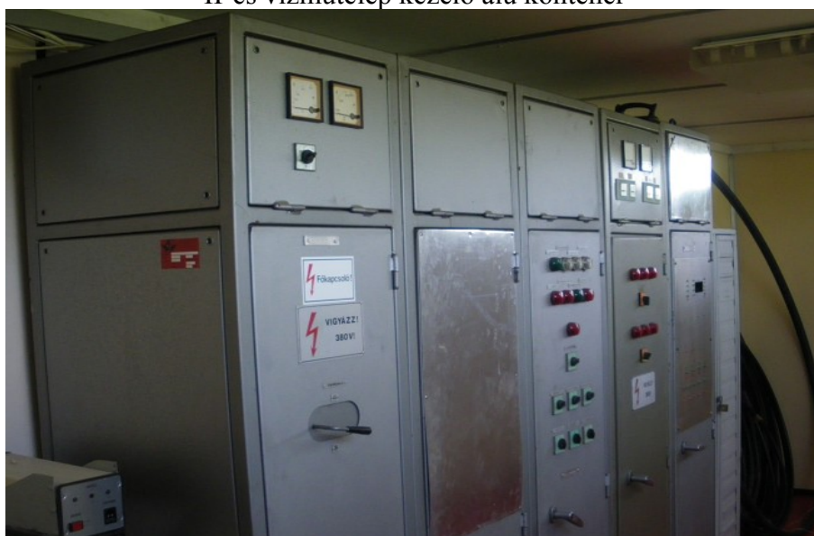
II-es vízműtelep főkapcsoló szekrény
