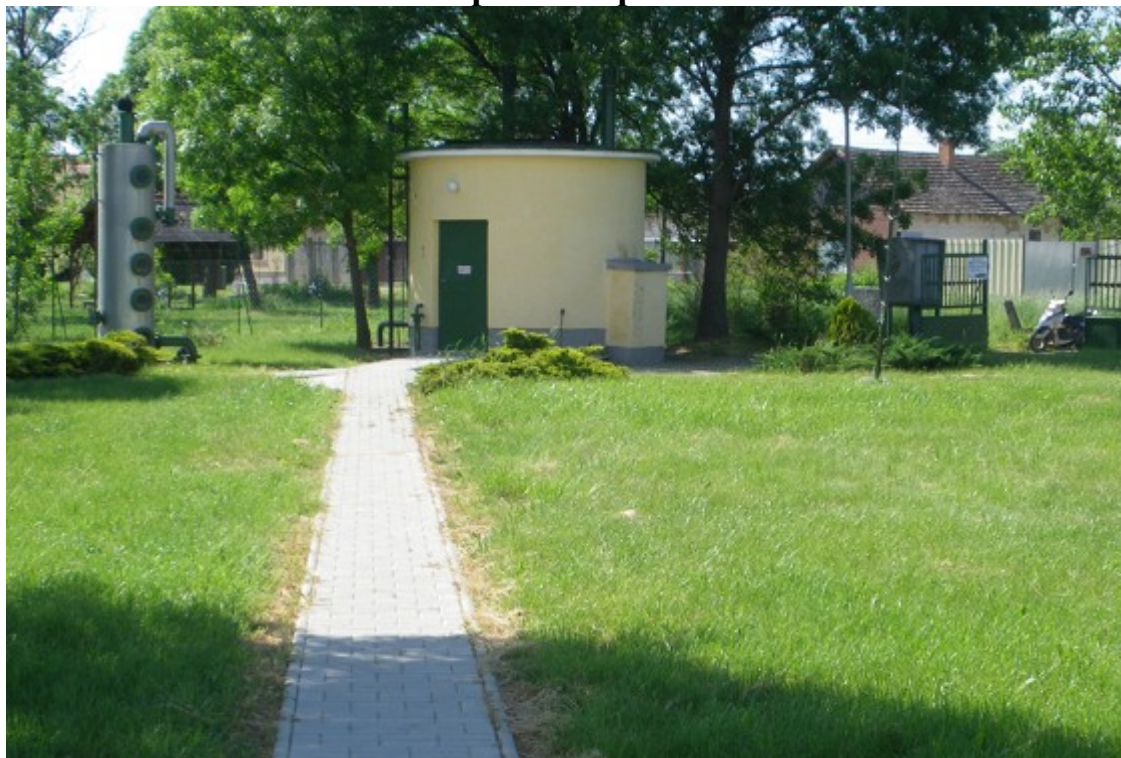
I-es vízműtelep 1-es kút és gáztalanító berendezés
